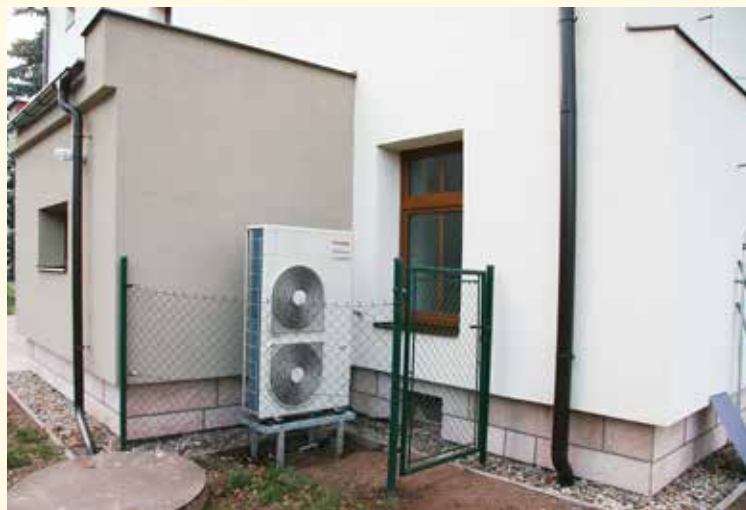
Část tepelného čerpadla
